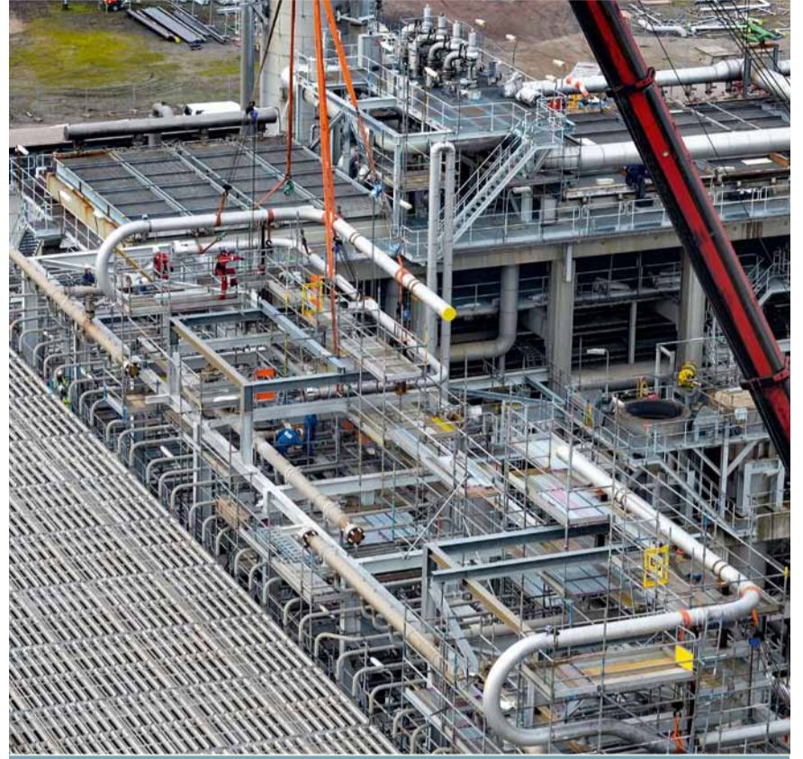
Ein echter Hingucker: die Hydrocracking-Einheit für Shell Pernis
